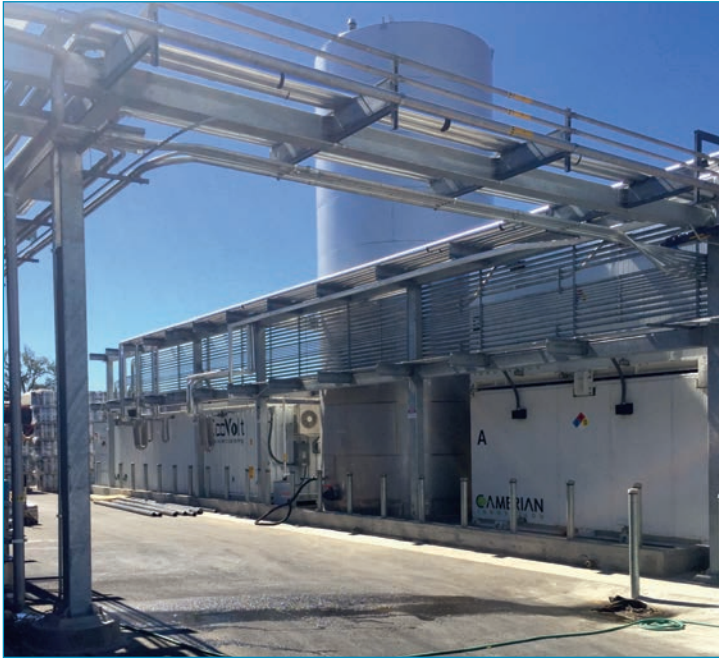
EcoVolt Modules At Grade
